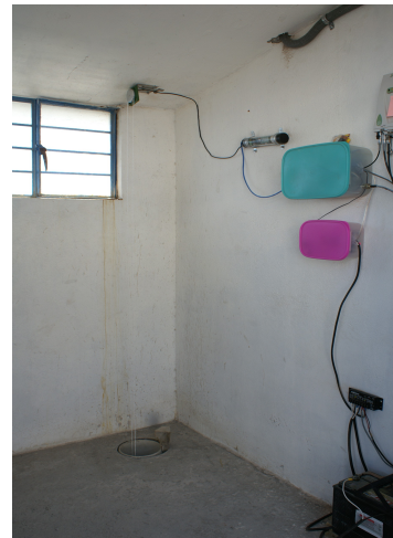
SALINA CRUZ, OAX. EQUIPO INSTALADO: MAREOGRAFO, EQUIPO DE COMUNICACIÓN Y GPS
